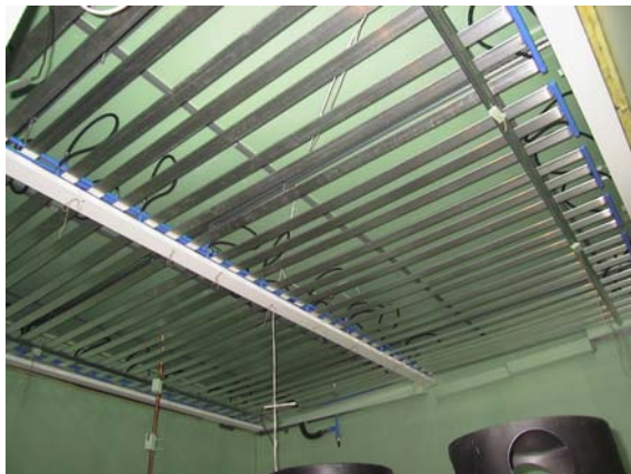
Bild 10.14 Clina-Wärmeleitpaneele als thermisch aktives Grundsystem installiert im Prüfraum nach DIN 4715 an der Westsächsischen Hochschule Zwickau (FH)
